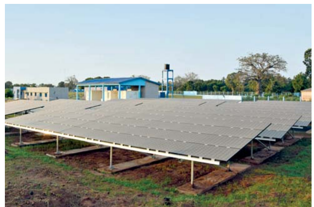
Panneaux photovoltaïques utilisés par Bluesun.
